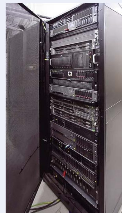
Серверное оборудование ИТ-отдела. Server equipment of IT department.
