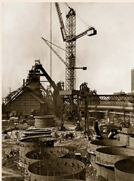
Строительство доменной печи №5 НТМК. Construction of Number 5 blast furnace at Nizhny Tagil Iron-and-Steel Works.
